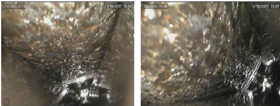
Imagem 5: Pista interna e elemento rodante do rolamento – lado do gerador, antes do tratamento
